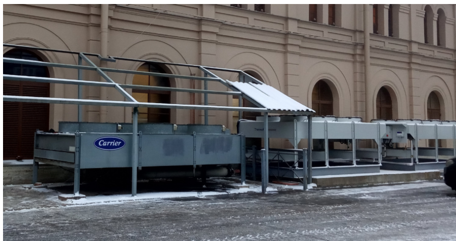
Рисунок 8 – Устройство внешних блоков холодильных машин без шумозащитных мероприятий
